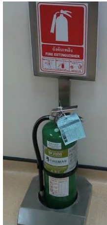
รูปที่ 25 ถังดับเพลิงแบบเคลื่อนที่
