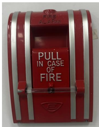
รูปที่ 20 ระบบแจ้งเหตุเพลิงไหม้ด้วยมือ
